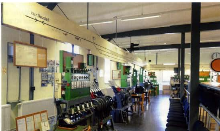
Die westliche Seite mit den ältesten Stellwerken. Oben auf der weissen Tafel die virtuellen Aussenanlagen.
