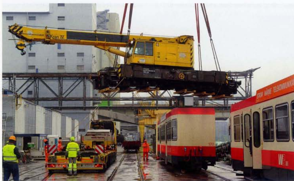
Der Vanomag-Kran IV (Gottwald, 112 t, Tragfähigkeit 45 t) VTmaass 99 85 9219 024-8 wurde am 30.4.2021 im Auhafen über die früheren WB-Fahrzeuge hinweg zum Transport via Rotterdam nach Ägypten verladen. Foto: J.D. Lüthard
