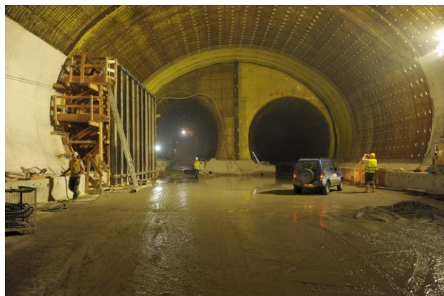
Abzweigung Haupttunnel – Verbindungstunnel, Blickrichtung Haupttunnel. Die beiden Röhren führen in die Gleisüberwerfung für den Wechsel von Rechts- auf den Linksbetrieb. (Foto: J. Lüthard, 05.06.2019)
