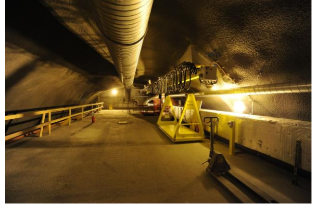
Multifunktionsstelle Faido, die Kaverne quer über den beiden Röhren. Unten die Räume mit den Installationen. (Foto: J. Lüthard, 31.10.2013)
