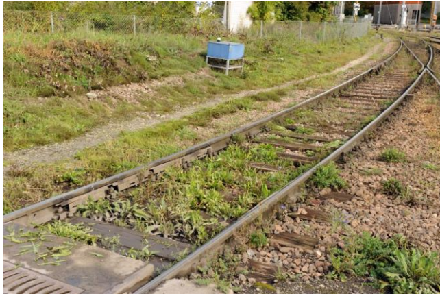
Was die SBB nicht will, geht bei einer Industriebahn problemlos! Für die Schienenschmieranlagen sind in der Schiene präzise Bohrungen vorhanden, durch die vor jeder Durchfahrt kleinste Mengen eines umweltfreundlichen Fettes gepresst werden. Im Hintergrund die dazugehörige Anlage. (Foto: J. Lüthard, 22.09.2023)
