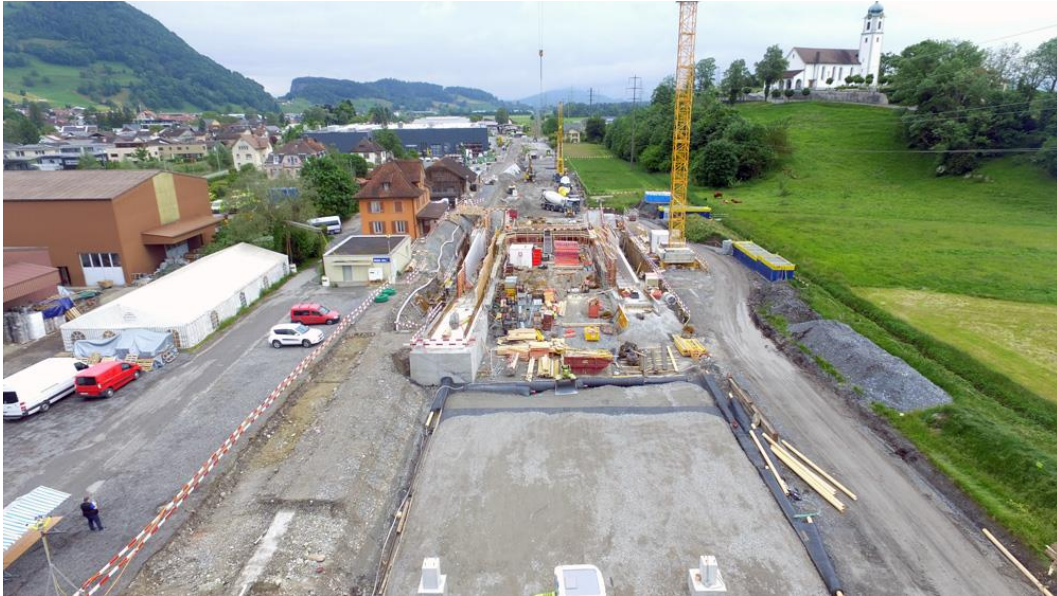
Am Bahnhof Rüthi gut zu erkennen links das Bahnhofsgebäude und das davorstehende Technikgebäude, in der Mitte die neue Unterführung. Anhand dieser ist gut zu erkennen, wie tief das bestehende Erdreich ersetzt wird. Im Vordergrund zwei der vorgefertigten massiven Mastfundamente. (Foto: J. Lüthard, 24.05.2023)
