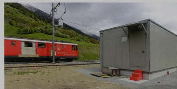
Im Rahmen ihres Erneuerungsprogramms hat die Matterhorn Gotthard Bahn jetzt neun neue Stellwerke in Betrieb genommen.
