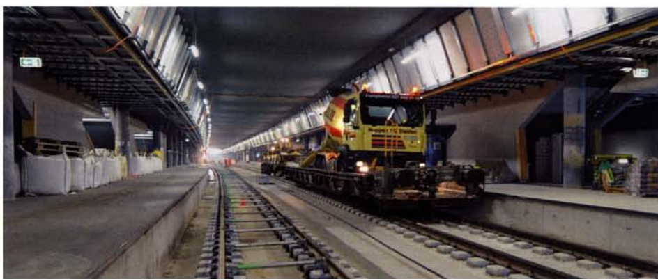
Die Einbetonierungsarbeiten der Festen Fahrbahn im Bahnhof Löwenstrasse waren am 16. April 2013 bereits weit fortgeschritten (Foto: J. Lüthard).
