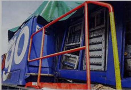
Links: Die Schäden im Maschinenraum der Am 843 091 (Foto: 6909, 4. Mai 2021).
