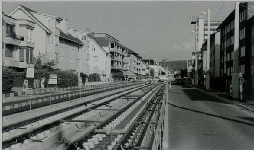
Am 11. Juni 2021 waren in der Badenerstrasse in Dietikon die Schienen weitgehend verlegt.
