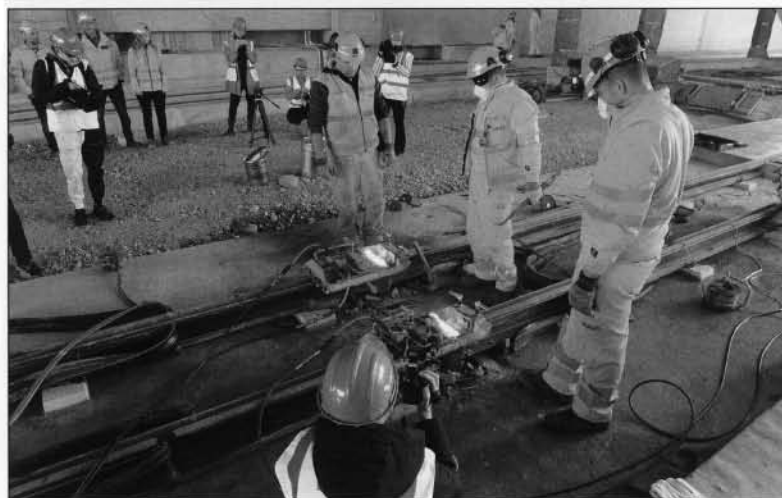
Das letzte Gleis der 13,4 Kilometer langen Strecke der Limmattalbahn wurde am 11. April 2022 gegen 11 Uhr beim Shoppi Tivoli in Spreitenbach verschweisst.
