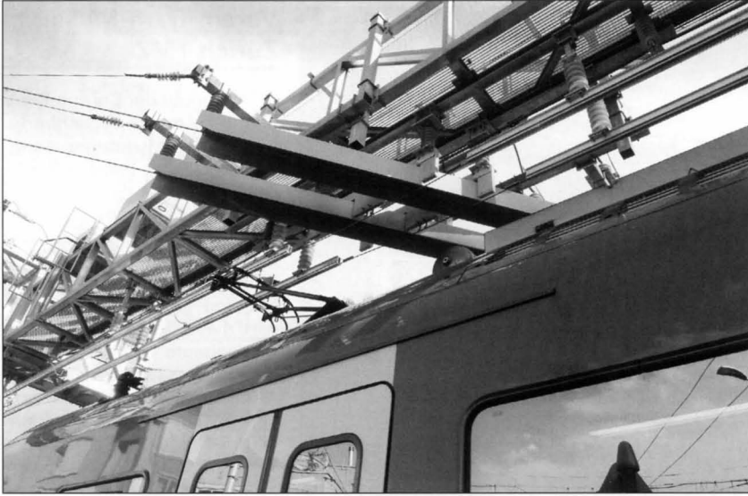
Sihltal – Zürich – Uetliberg-Bahn SZU: Detailaufnahme der Fahrleitungskreuzung an der Friesenbergstrasse.
